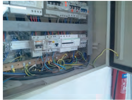
مكونات خزانة كهربائية وتثبيت غير سليم لمطفأة حريق
