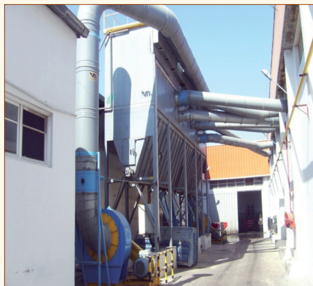
Aspiration à la source et récupération des poussières de bois
