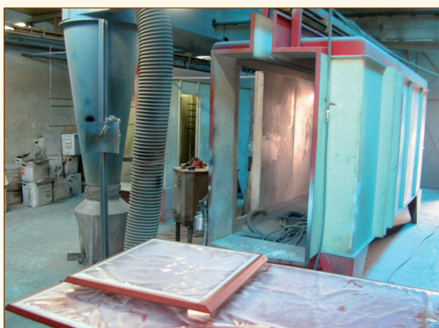
Cabine de peinture au pistolet équipée d'un système de ventilation
