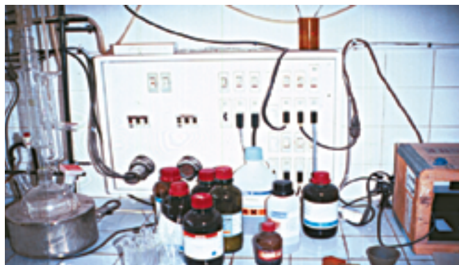
Produit inflammable en présence de source d'ignition – tableau électrique mal placé
